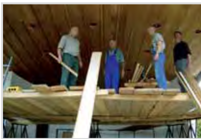
Im Oktober 2004: Erneuerung der Decke im Zuge der Renovierung des Musikpavillons durch den Musikverein, der sich mit der großen Zahl von 331 Stunden einbrachte (von links nach rechts: Martin Sabold, Franz Loferer, Josef Zaiser, Rupert Loidl). Weitere Vereine – Schützen, Sportclub, Tennisclub – und viele private Helfer arbeiteten ebenfalls mit.
